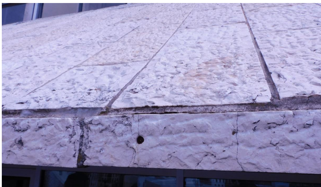
איור 51 - ח. מערבית ק-6 - ראש בורג חלוד חשוף + מישק במילוי כוחלה מתפרק
