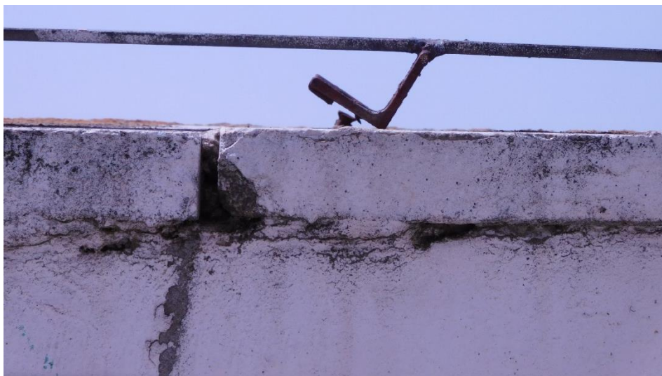
איור 21 - קופינג במפלס הגג – נדרש להוסיף קיבוע מכני בקופינג, חידוש מילוי מישק, טיפול בחומר ייעודי להסרת עובש לפני יישום סילר
