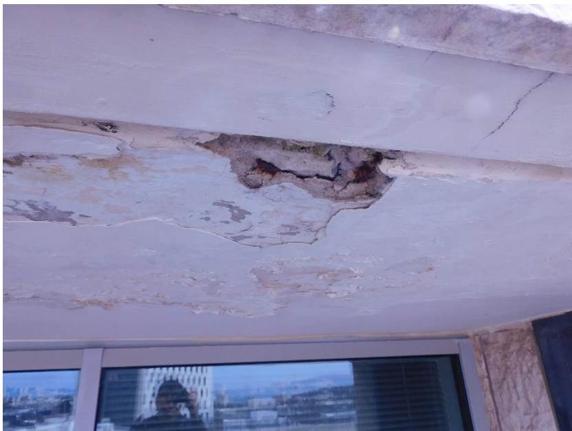
איור 52- ח. מערבית ק-6 - ברזל בניין חלוד וסימני רטיבות בתקרה
