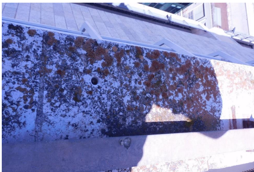
איור 20 - קופינג בחזית מערבית – נדרש חידוש מילוי מישק, טיפול בחומר ייעודי להסרת עובש לפני יישום סילר
