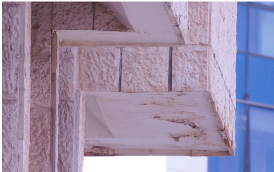
איור 54 - פינה צפון מערבית - תחתית רצפה - התקלפות צבע וכתמי חלודה
