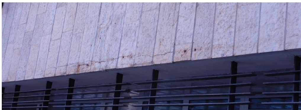
איור 10 – מבנה אגף דרומי - זוויתן חלוד בגב האבן – הדורש טיפול
