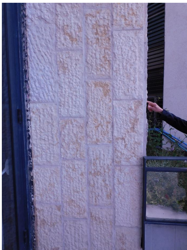
איור 40 - ח. דרומית - מפלס הקרקע בסמוך לכניסה - לוחות אבן שהודבקו שלא עפ"י ת"י 2378/4
